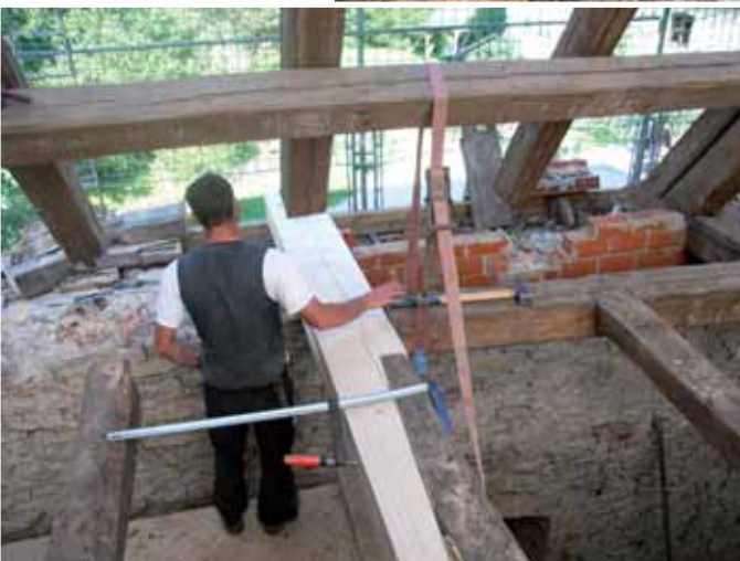
Nach der Abnahme der Dach- deckung. Die zerstörte Traufe. (Aug. 2006)
